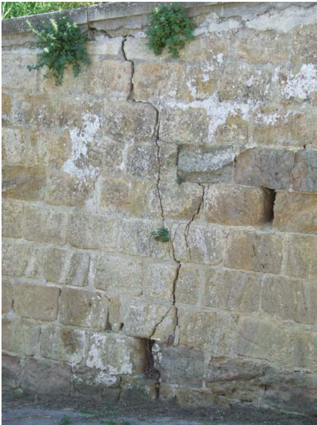
Figura 119 I fenomeni franosi in via Costa generano la fatturazione del muro di sostegno del versante
