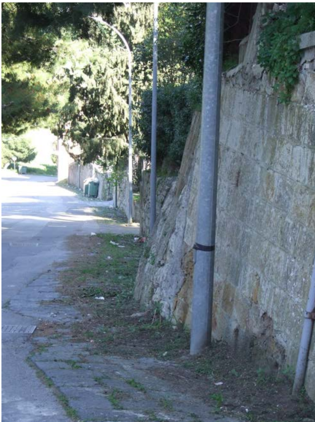
Figura 118 Evidenti fenomeni franosi in via Costa sul muro di sostegno del versante
