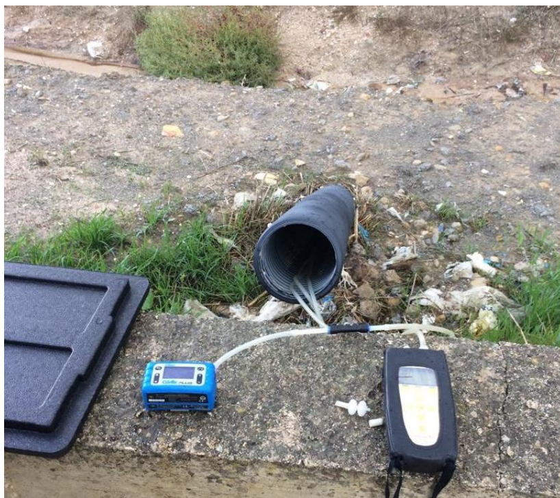
Figura 22 - Punto rappresentativo di campionamento su tubazione estrazione biogas
