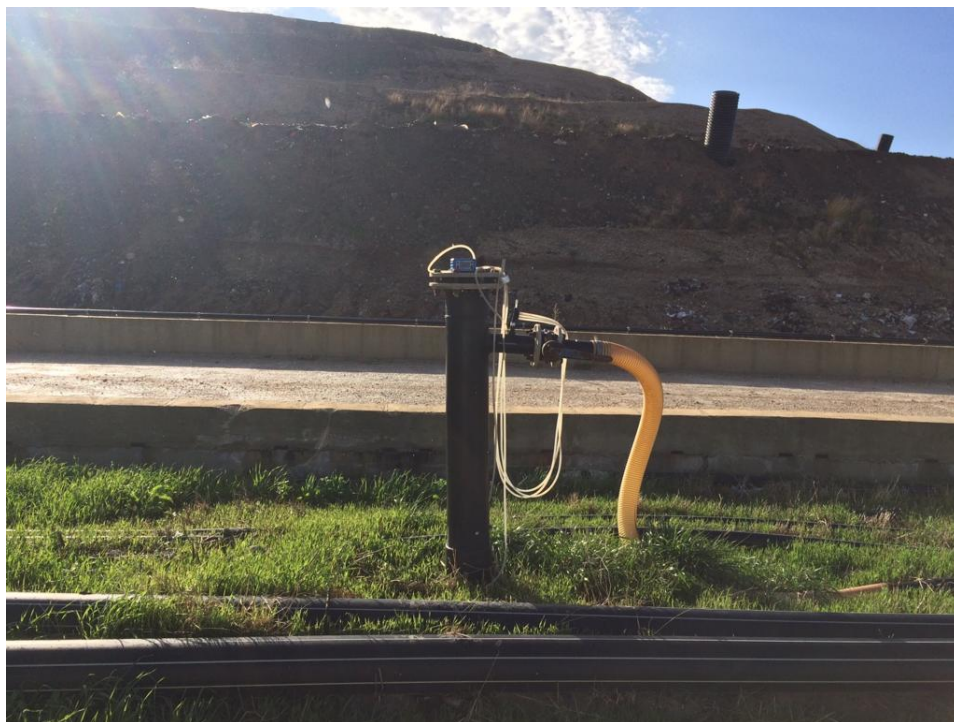
Figura 23 - Punto rappresentativo di campionamento su tubazione estrazione biogas)
