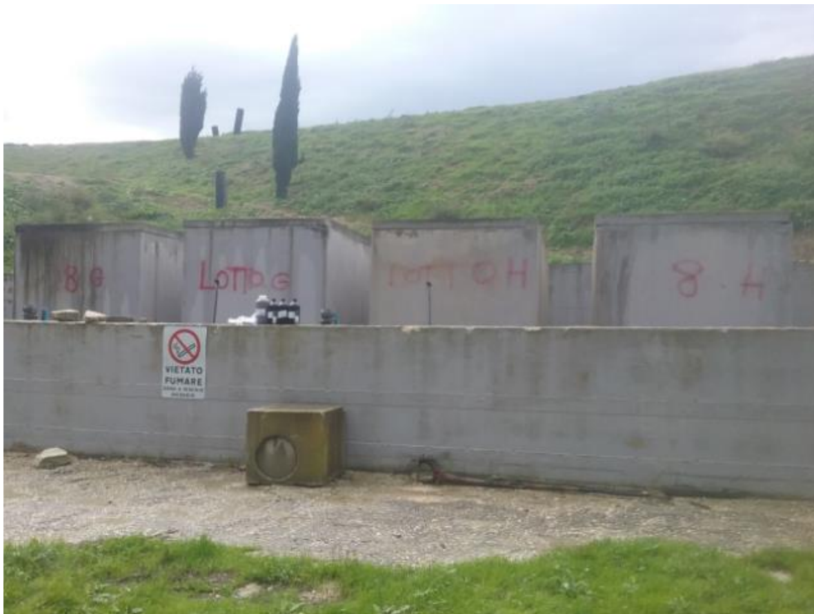
Figura 9 – Serbatoi raccolta percolato vasche G e H
